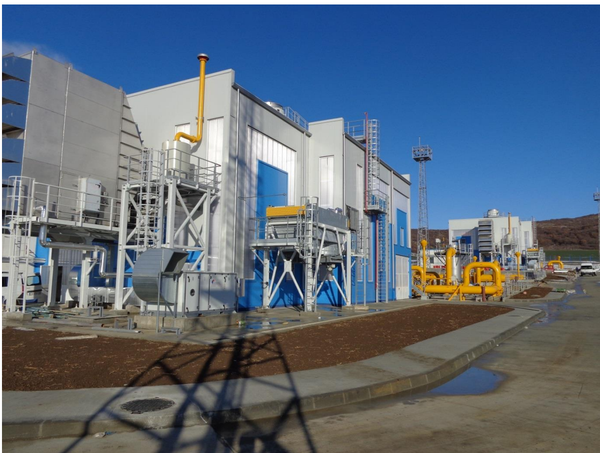
Компресорна станция „Лозенец“
