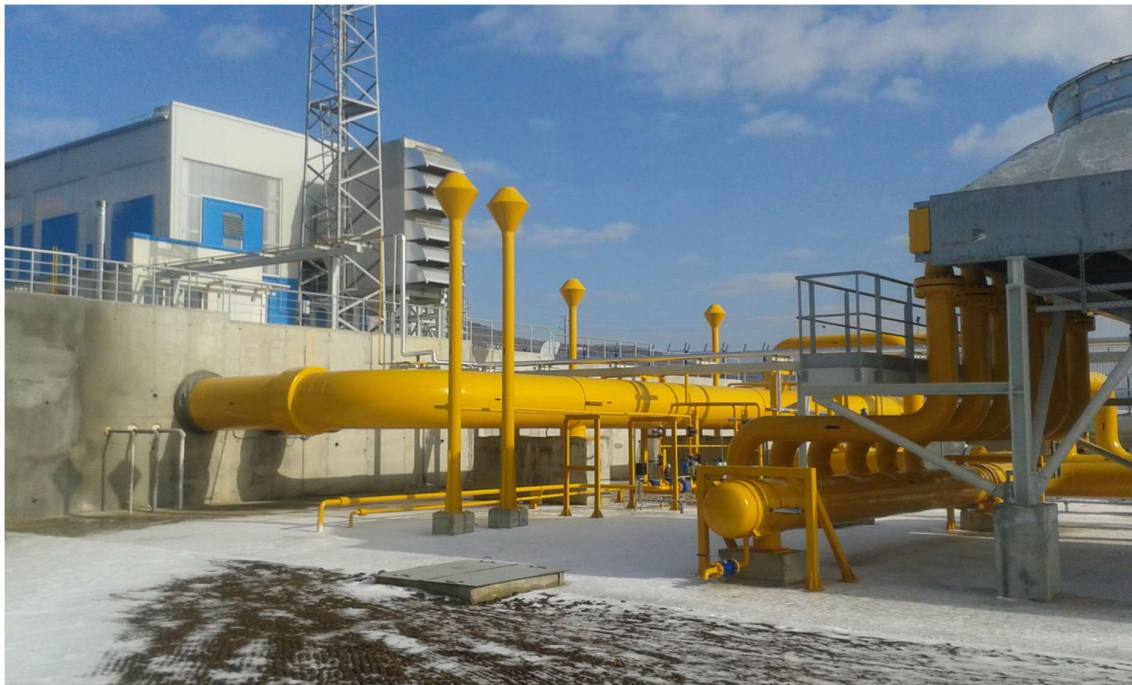
Компресорна станция „Лозенец“
