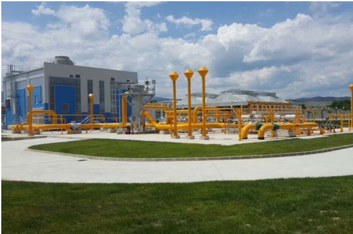
Компресорна станция „Ихтиман“
