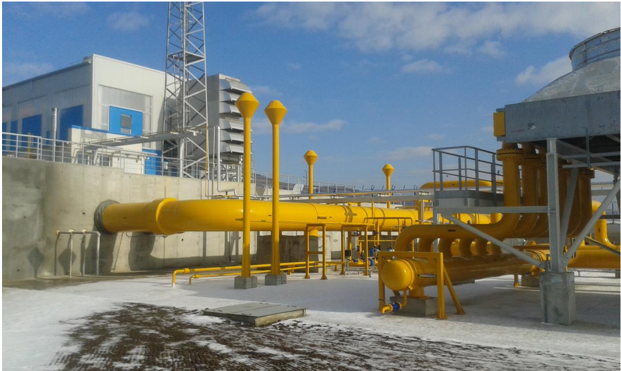
Компресорна станция „Лозенец“
