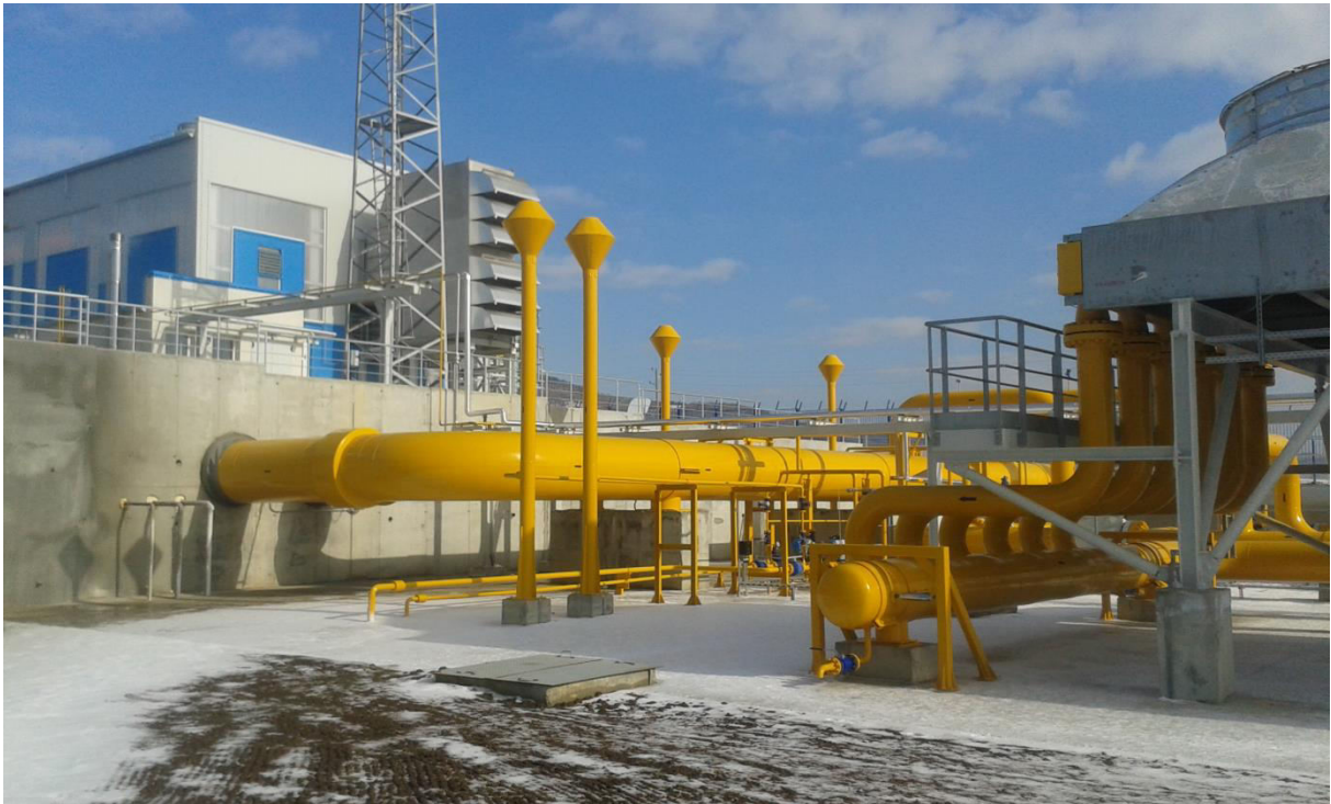
Компресорна станция „Лозенец“
