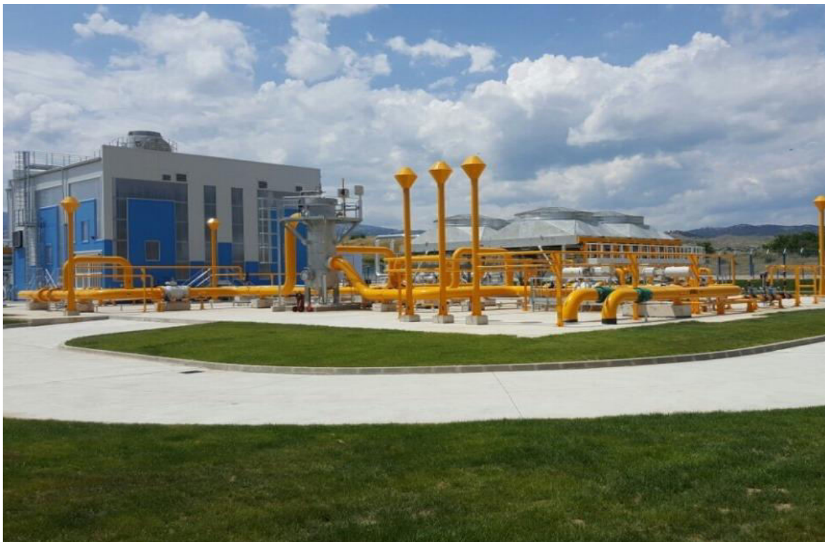
Компресорна станция „Ихтиман“
